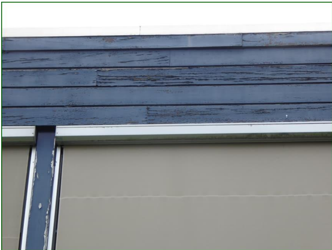
Figuur 4: de betimmering op de gymzaal was op verschillende plaatsen losgeraakt of vertoonde kieren. Een verblijf van een vleermuis kon tijdens de quickscan niet worden uitgesloten. Uit het vervolgonderzoek is gebleken dat vleermuizen geen gebruik maken van het pand.
