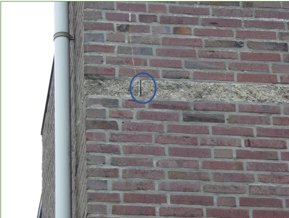
Foto 4: de voeg tussen de betonnen sierrand op de sportzaal is verdwenen en kan door (dwerg) vleermuizen gebruikt worden.
