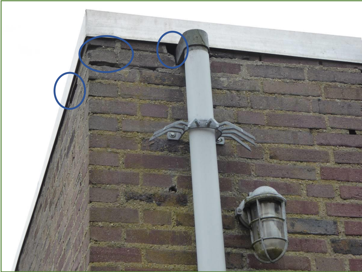
Foto 5: bij de regenpijpen zitten diverse gaten die door vleermuizen gebruikt kunnen worden.
