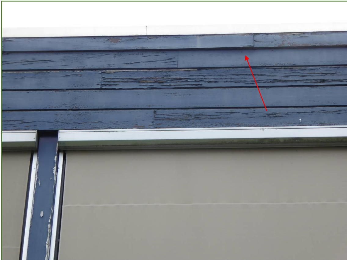
Foto 9: planken boven de ramen wijken op een aantal plaatsen van elkaar. Van de opening en ruimte achter de planken kunnen vleermuizen gebruik maken.
