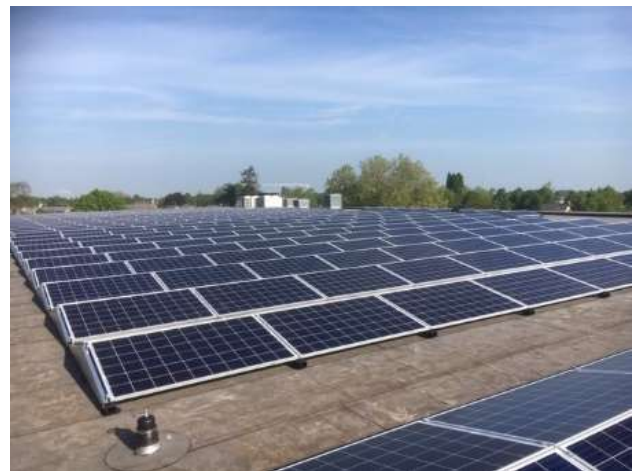
Zon op dak van de Werft in Kaatsheuvel foto AG Techniek
